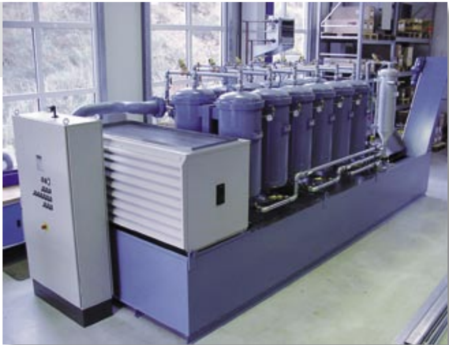
Bild 2: Zentralanlage für Schleiföle in der Hartmetall-Werkzeugfertigung für 15 Maschinen
