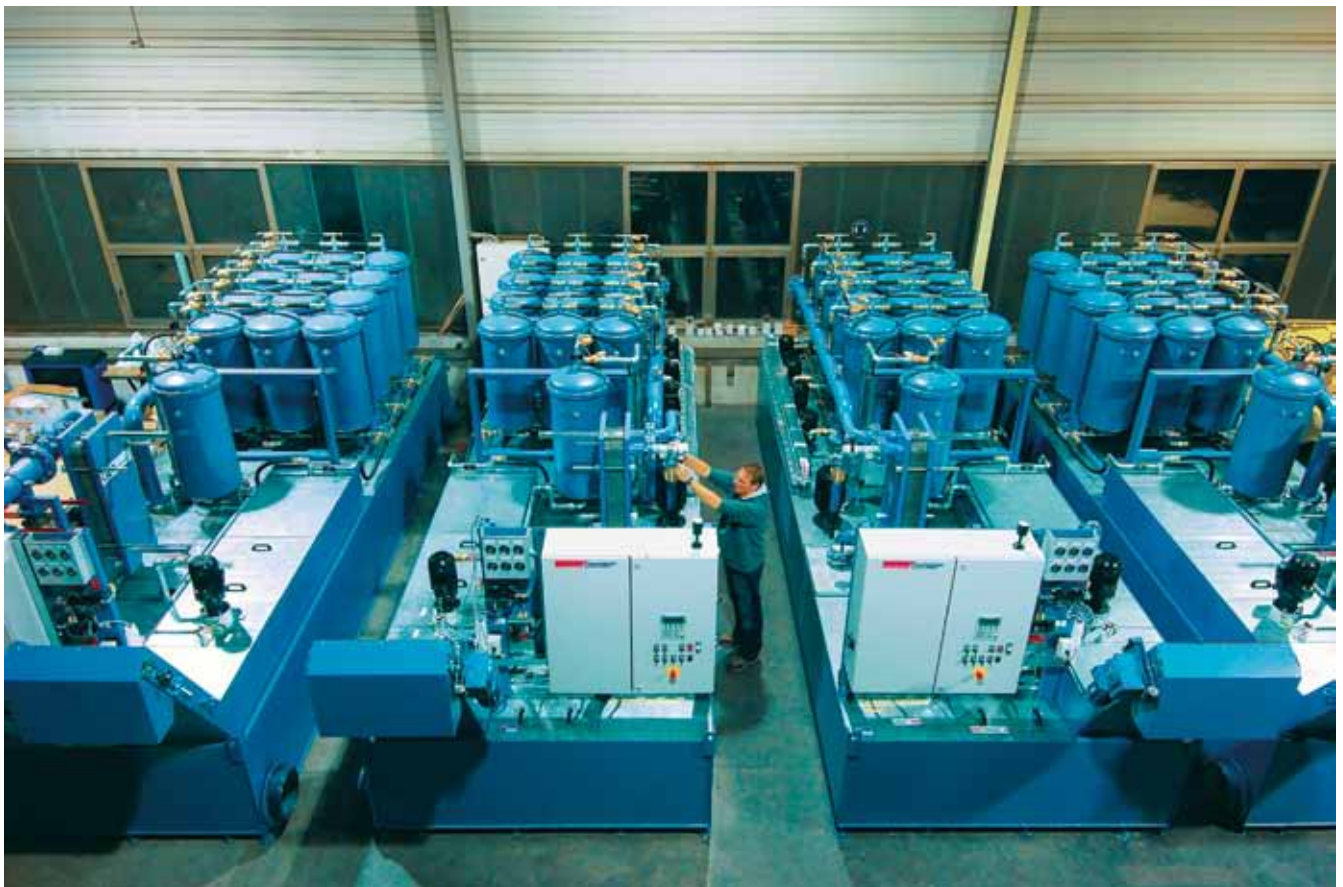
Bild 2: ...wie als Zentralanlagen für bis zu 100 Werkzeugmaschinen (Werkbilder: Transor Filter GmbH, Usingen)
